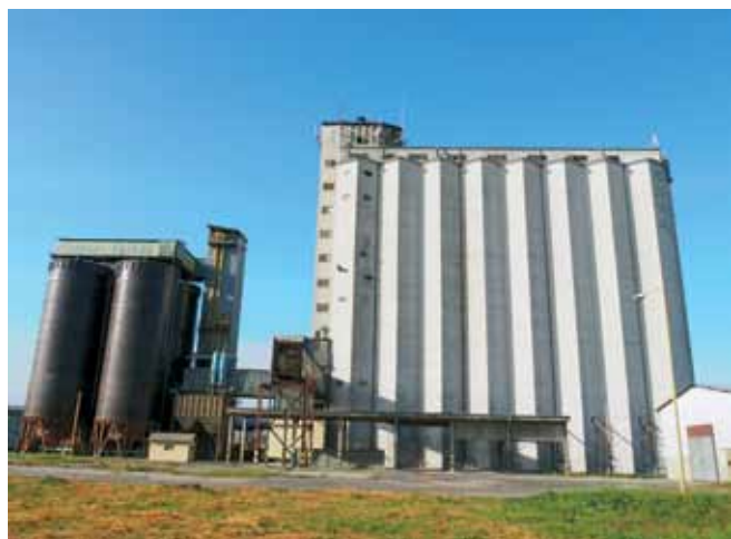
Pohľad od železnice na veľkokapacitné železobetónové obilné silo RWA Podunajské Biskupice (1976 - 1977), vľavo sú v roku 1987 dostavané ocelové zásobníky.
