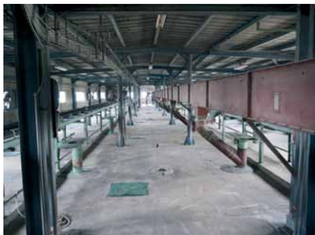
Interiér posledného poschodia s pásovými dopravníkmi pre nakladňovanie do buniek.
