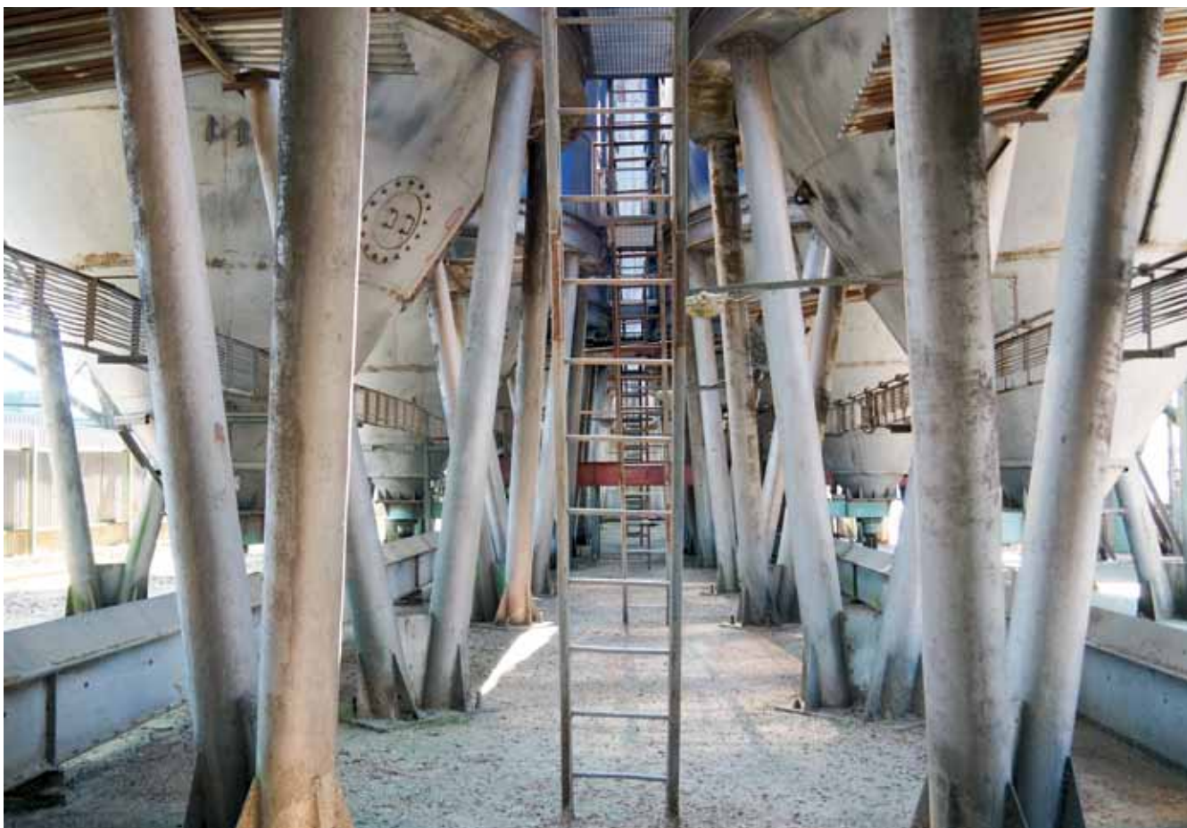
Pilierové osadenie ocelových zásobníkov OS 1 pod výpustami ktorých je krytý šnekový dopravník na vyskladňovanie.
