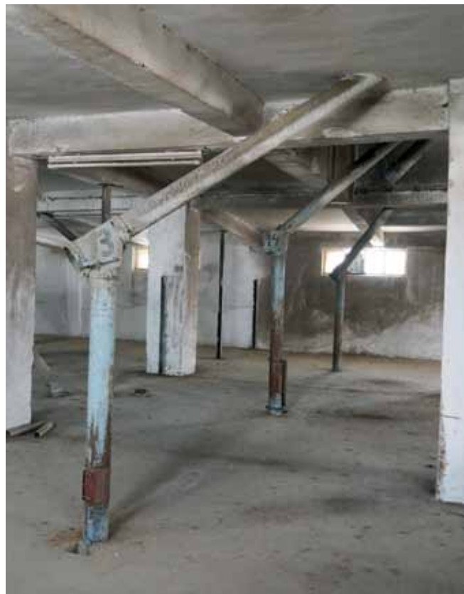
Interiér skladu s opornými stĺpmi na ktorých je upevnený systém na uchytenie drevených priehradiek, na fotke v strede zachované potrubné cesty pre samospád obilia.
